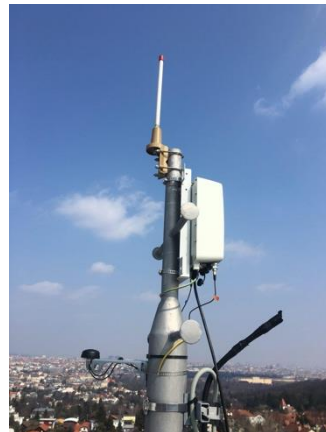
Ein LoRaWAN™ Access-Point. © SENS
